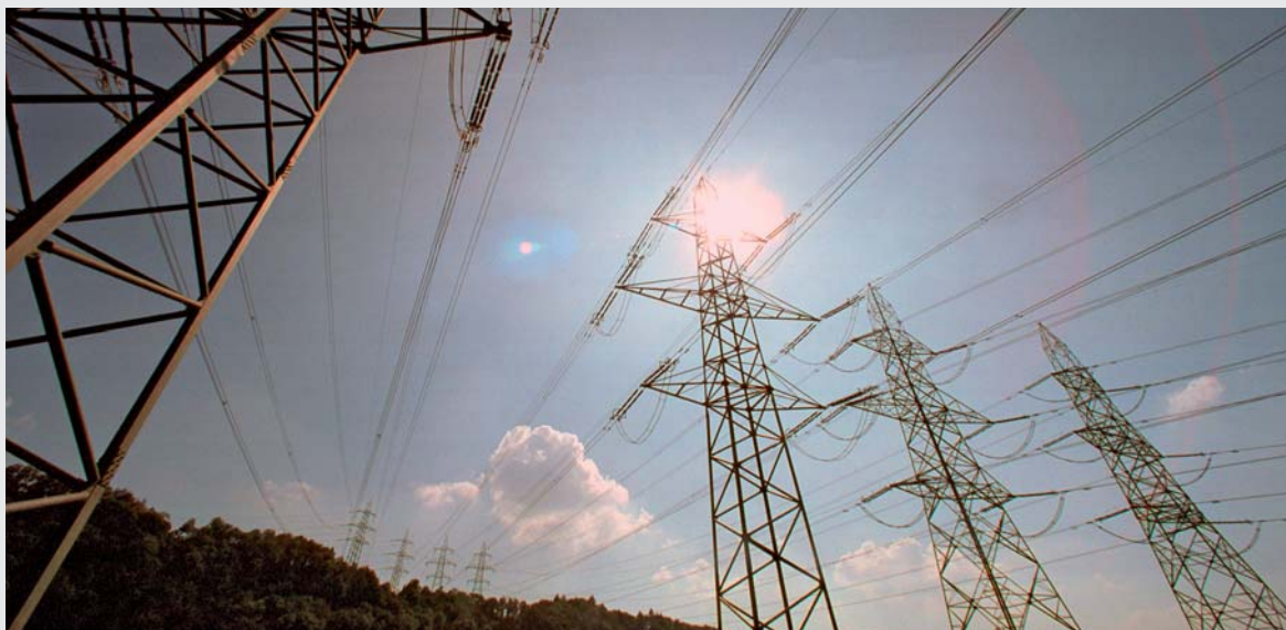
Pylônes du réseau à haute tension.
