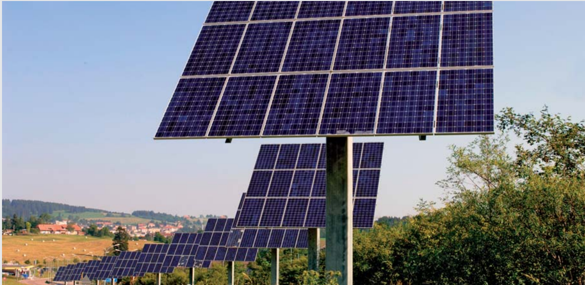
Modules solaires d'une grande installation d'énergie solaire à La Chaux-de-Fonds.
