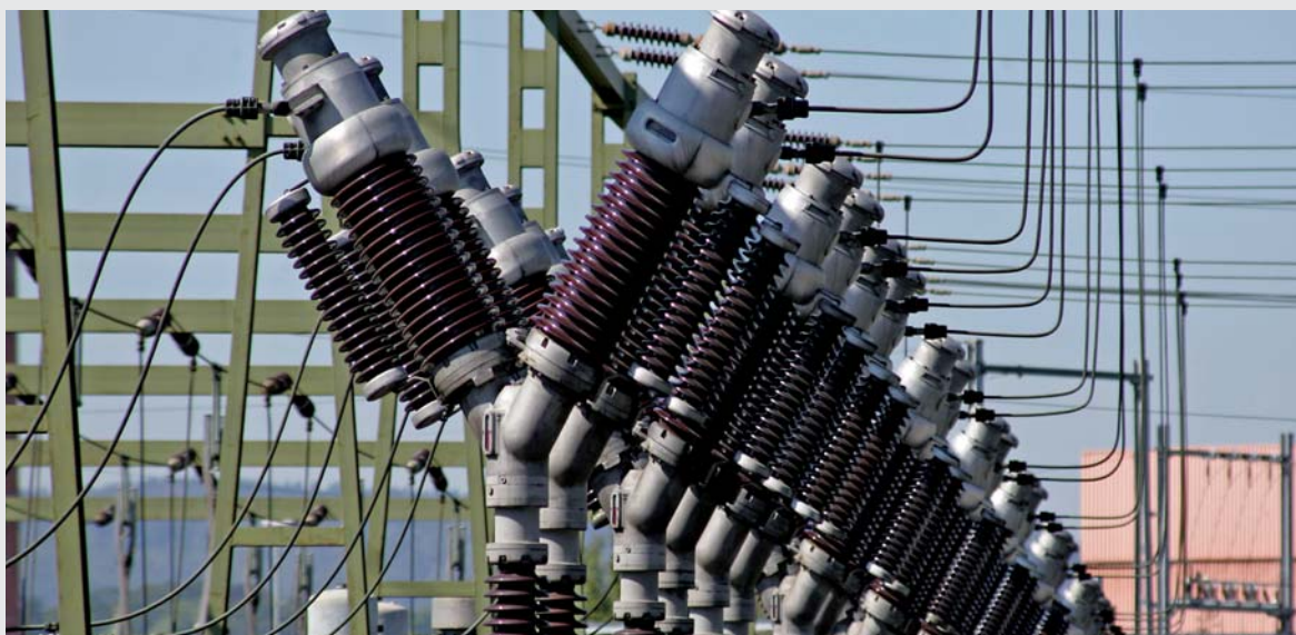
Sous-station de Laufenburg.
