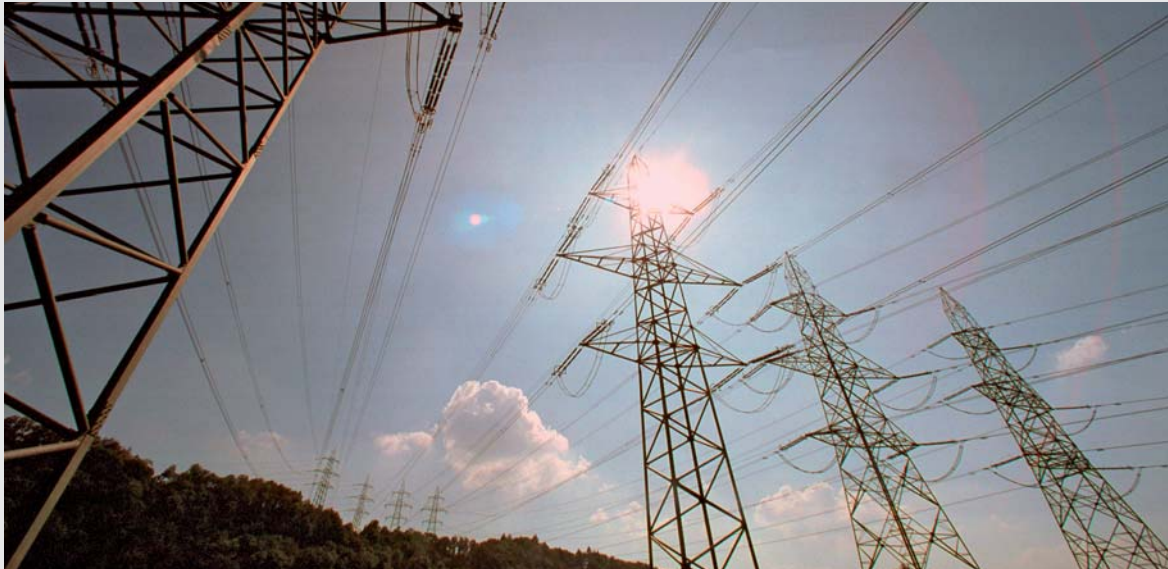
Masten des Höchstspannungsnetzes.
