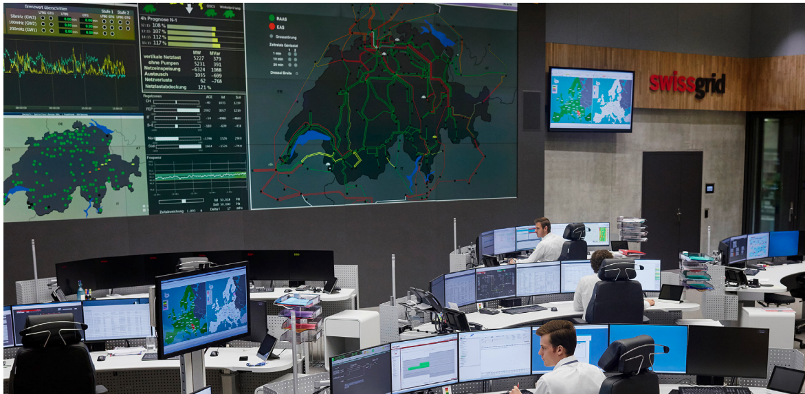
Die Netzleitstellen von Swissgrid in Aarau und Prilly bilden das Herzstück des Schweizer Übertragungsnetzes.
