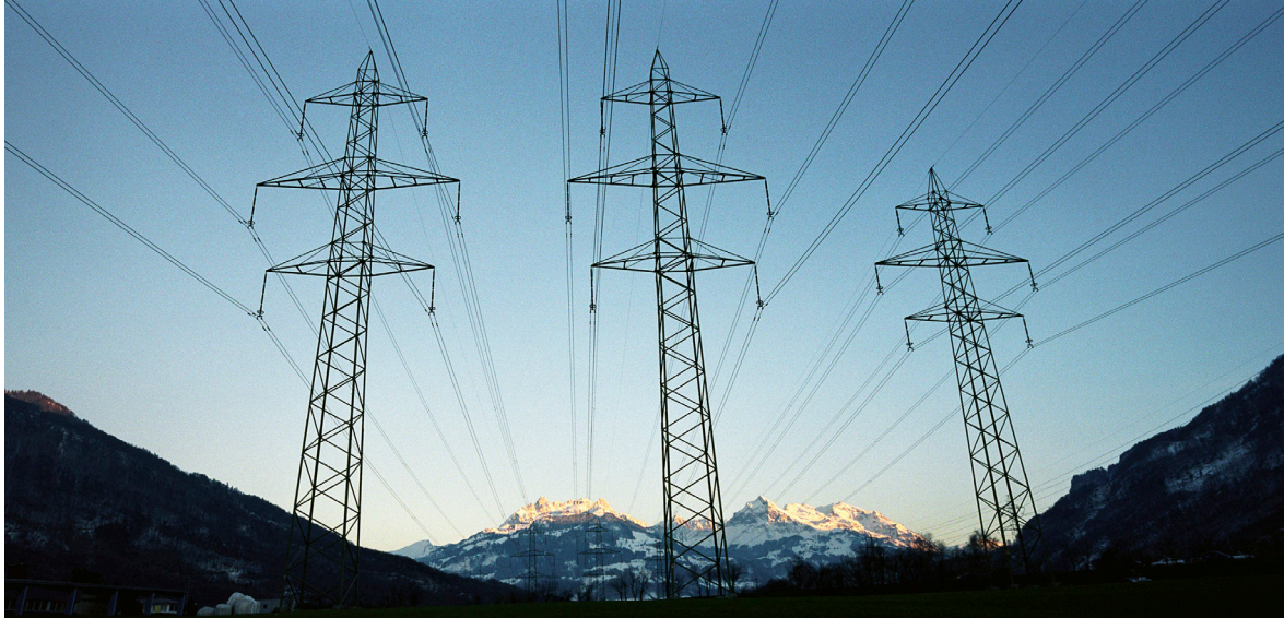
Swissgrid ist seit 2009 die Betreiberin des schweizerischen Übertragungsnetzes. Im Bild Strommasten des Übertragungsnetzes in der Linthebene.
